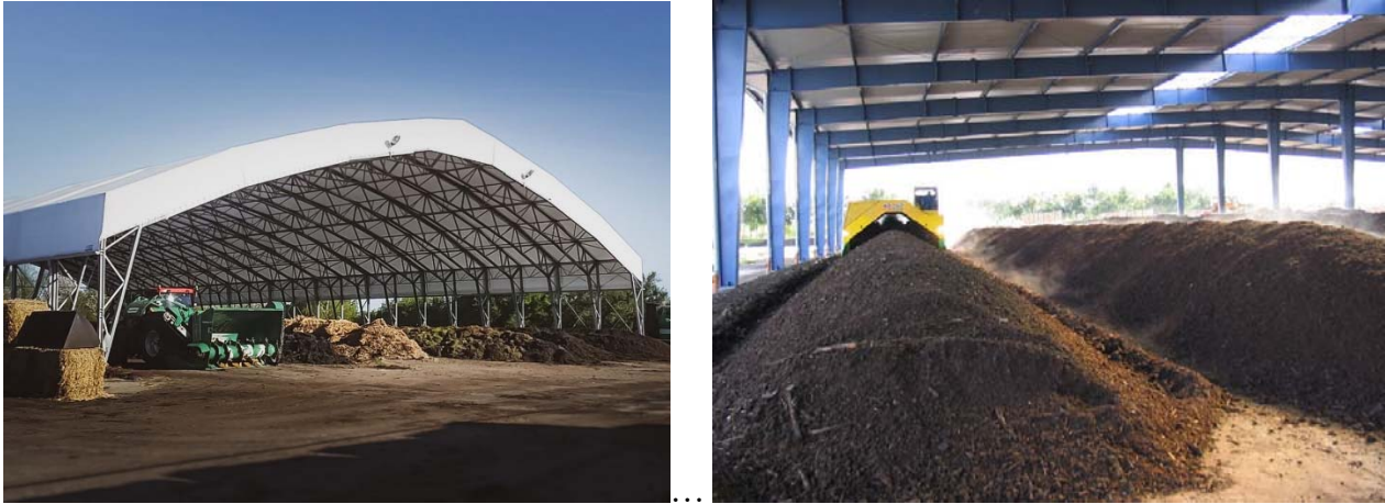
Рисунок 1.13 – Зовнішній вигляд установки компостування у буртах під дахом (джерело: https://www.compost-systems.com/en/solutions/sheltered-windrow-composting та https://tehnix.hr/en/ )
